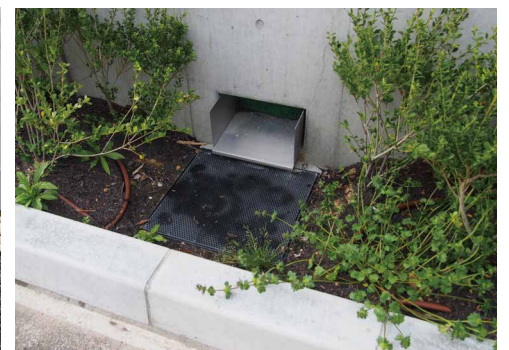
排放庭园雨水的导水明管面向人行道设置
