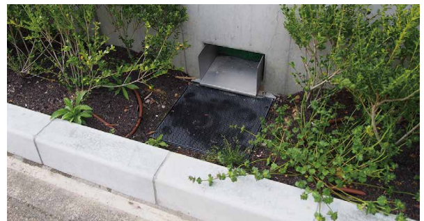
庭の雨水を放流する歩道に面した開放樋
